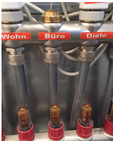
Ohne vieradriges Kabel keine Kühlung
